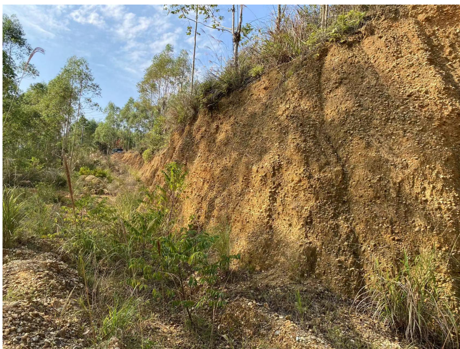
照片 5-2 不稳定斜坡 P003 至 P005 段（局部）
