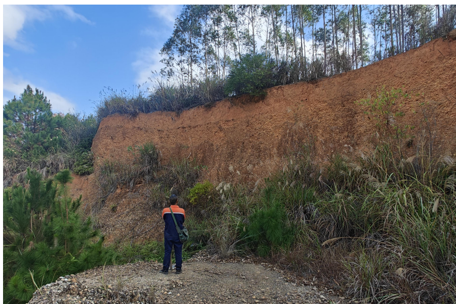
照片 5-1 不稳定斜坡 P001（局部）
